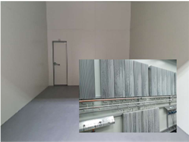
BILD 9. Fahrzeugtieftiefkältekammer mit integrierten Plattenwärmetauschern zur Konditionierung
